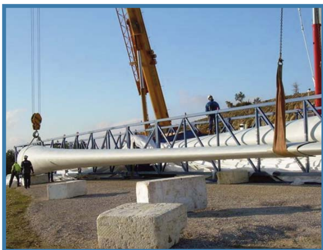
AFECCIONES EN PALAS, FIBRA, PINTURA
