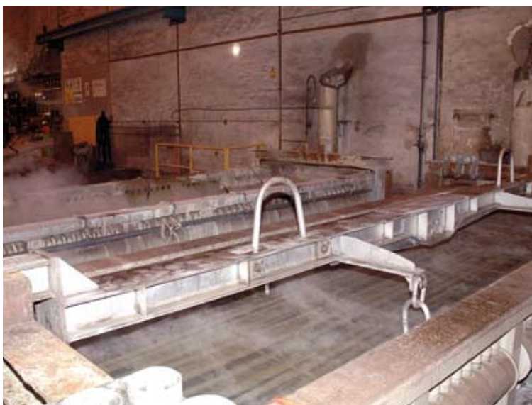
Línea de decapado químico
