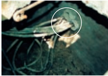
Figura 2: Interior de la arqueta (ver conductos pasacables)
