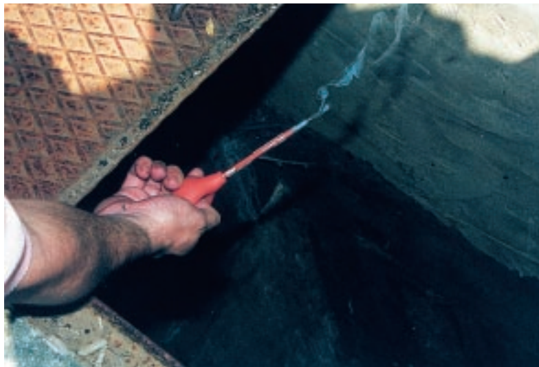
Ventilación natural en una arqueta
